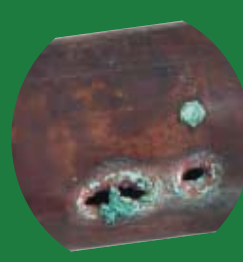
Picaduras: El tubo de cobre sin protección proporciona superficies de corrosión. El sulfato disuelto en el agua favorece las picaduras.
