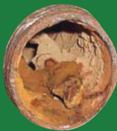
Antes: La corrosión y la cal forman depósitos irregulares en la pared interna de la tubería.
